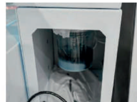
Tanque de tinta residual lleno Sensor
